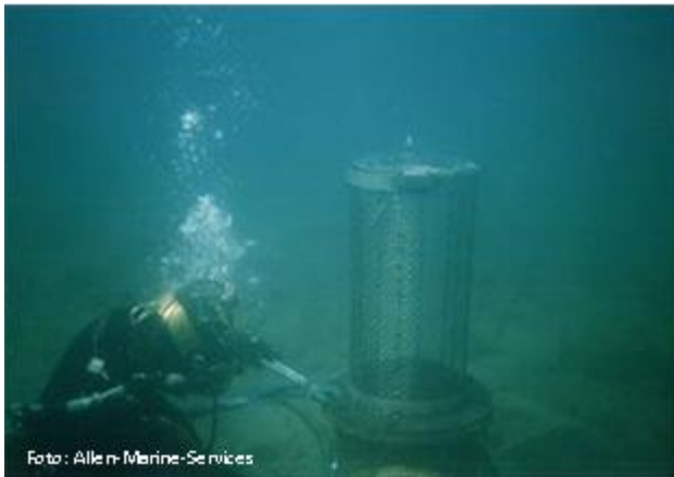
Figuur 24: Een diffuser die kan voorkomen dat een duiker vastgezogen wordt
