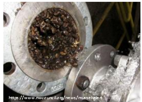
Figuur 23: Voorbeeld van een verstopping in een leiding
